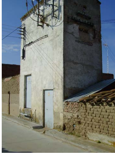
Centro de Transformación Eléctrica (I)
